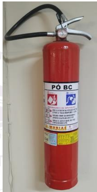
Imagem 2 – Extintor de incêndio (Pó Químico Seco BC)
